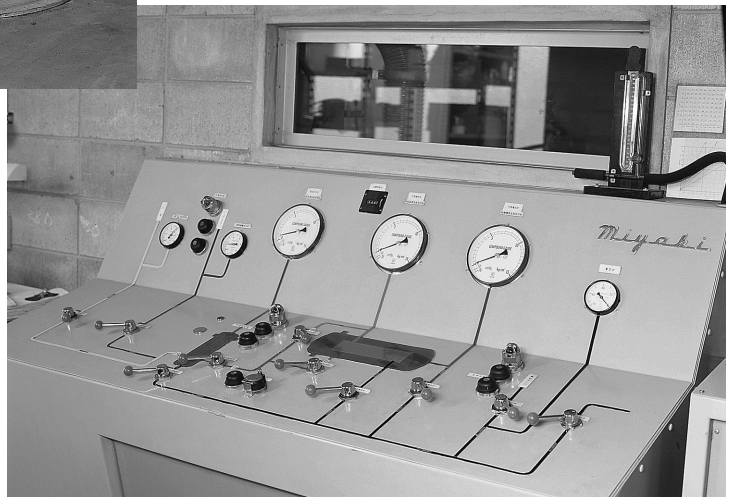
爆発引火強度用操作盤
